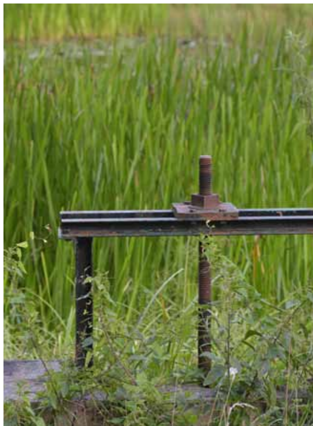
Zastawka na rowie doprowadzającym wodę do zbiornika.
